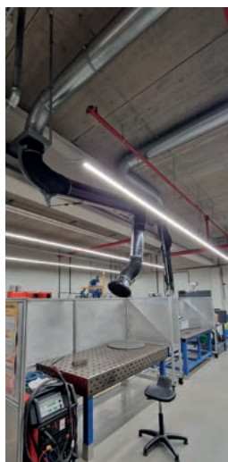
Bracci di estrazione collegati a un'unità centralizzata di filtrazione.
